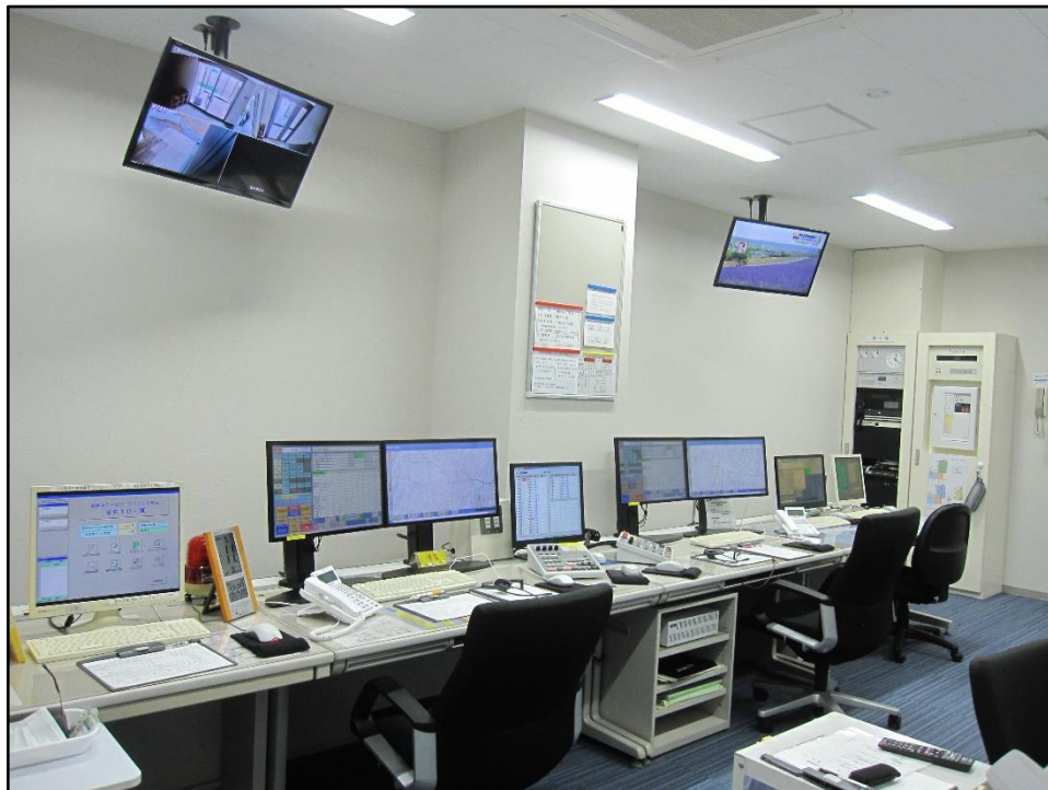
美幌・津別広域事務組合消防本部・美幌消防署通信指令室 令和2年6月24日 移設運用開始
